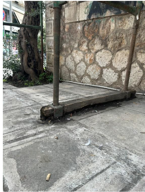
Φωτογραφία 21: Αποσάθρωση ξύλινου τάκου
