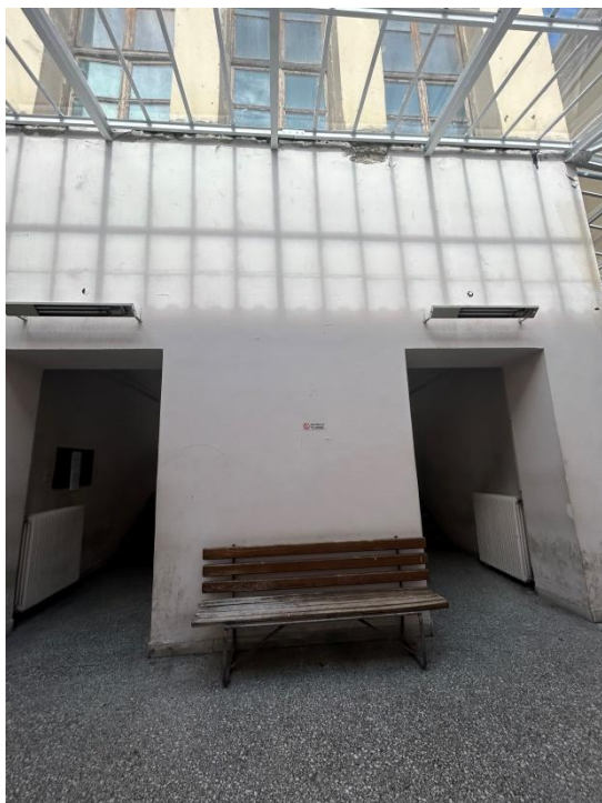
Φωτογραφία 19: Αποκόλληση επιχρίσματος μετά από τοποθέτηση στεγάστρου στο εσωτερικό του κτιρίου
