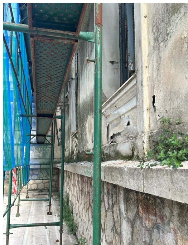
Φωτογραφία 6: Αποσάθρωση επιχρισμάτων άνωθεν του λίθινου γείσου
