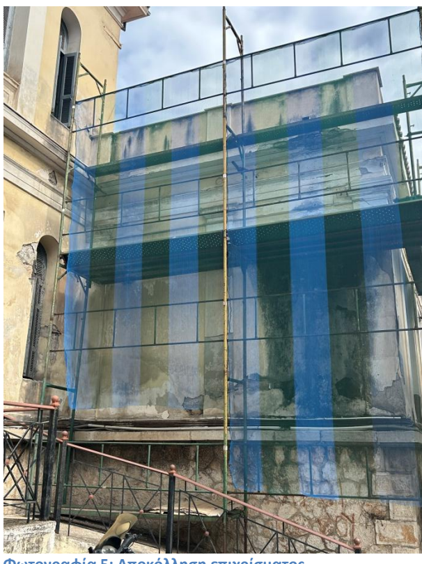
Φωτογραφία 5: Αποκόλληση επιχρίσματος
