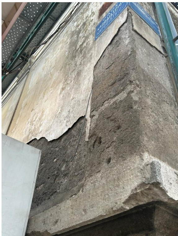
Φωτογραφία 15: αποκόλληση τμήματος σοβά στη συμβολή των οδών Καποδιστρίου & Λεωσθένους, με ανεπαρκή στήριξη του υφισταμένου
