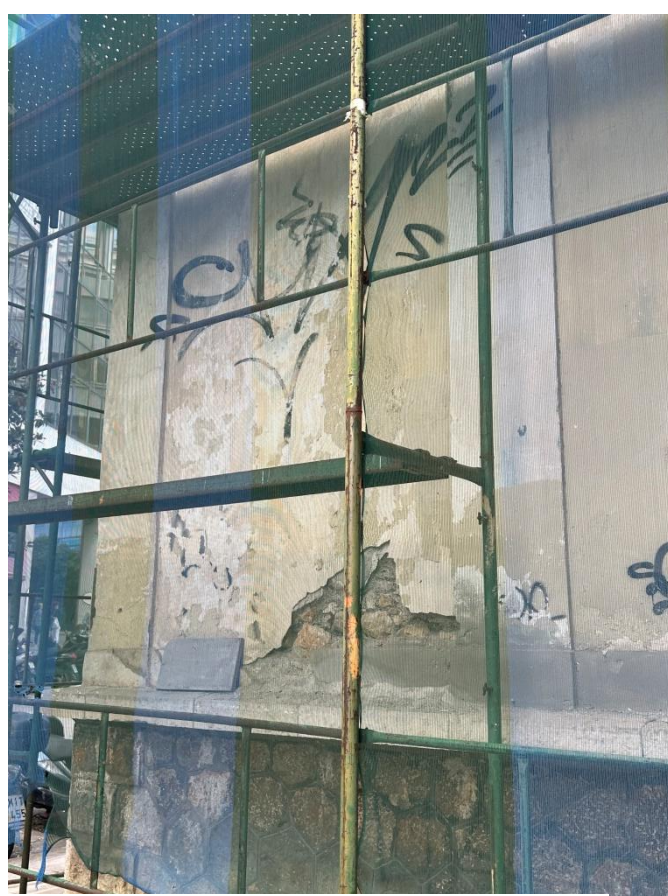
Φωτογραφία 12: αποκόλληση επιχρίσματος επί της νότιας όψης (οδός Χαντζοπούλου)
