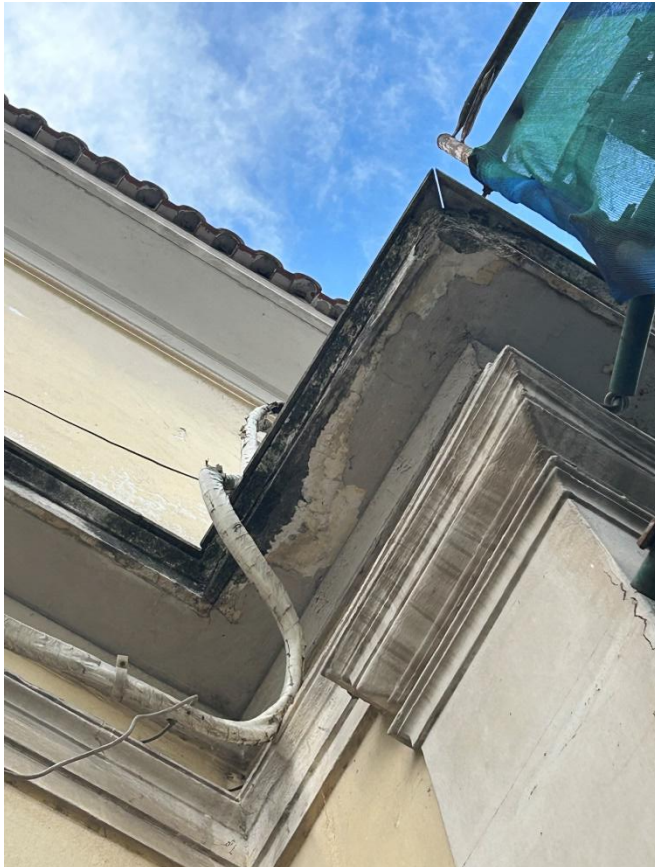
Φωτογραφία 17: Διάβρωση επιχρισμάτων λόγω ύπαρξης υγρασίας στα περιμετρικά γείσα με ανάπτυξη μούχλας
