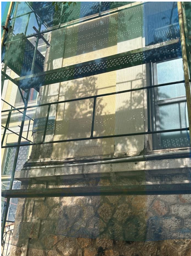
Φωτογραφία 3: απώλεια επιχρίσματος στη γωνία του κτιρίου, όπου αναρτήθηκε η ονοματοδοσία της οδού
