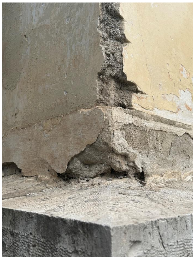
Φωτογραφία 7: αποκόλληση σοβά σε γωνία του κτιρίου
