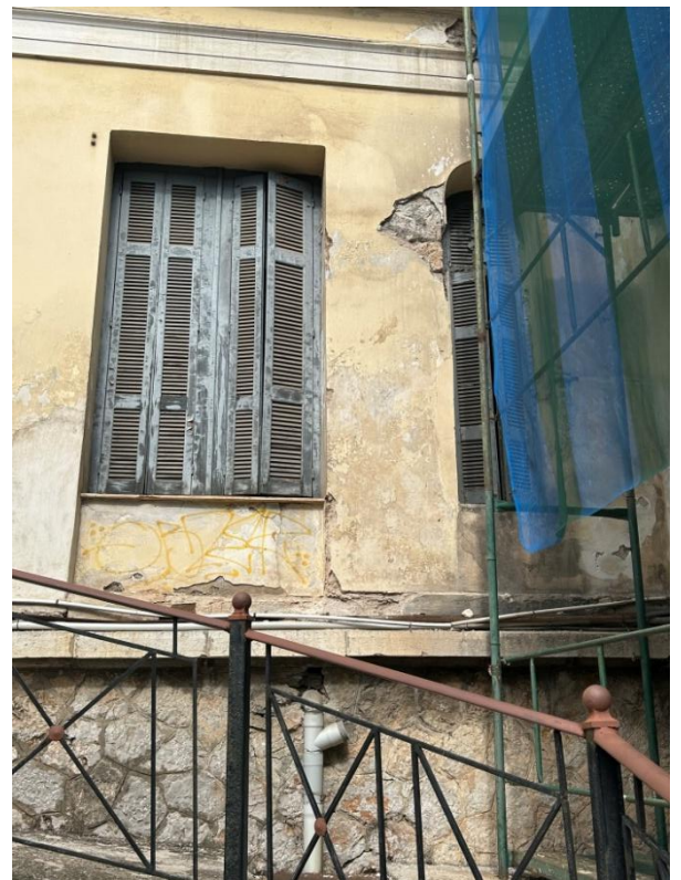
Φωτογραφία 4: αποκόλληση επιχρίσματος εκατέρωθεν παραθύρου
