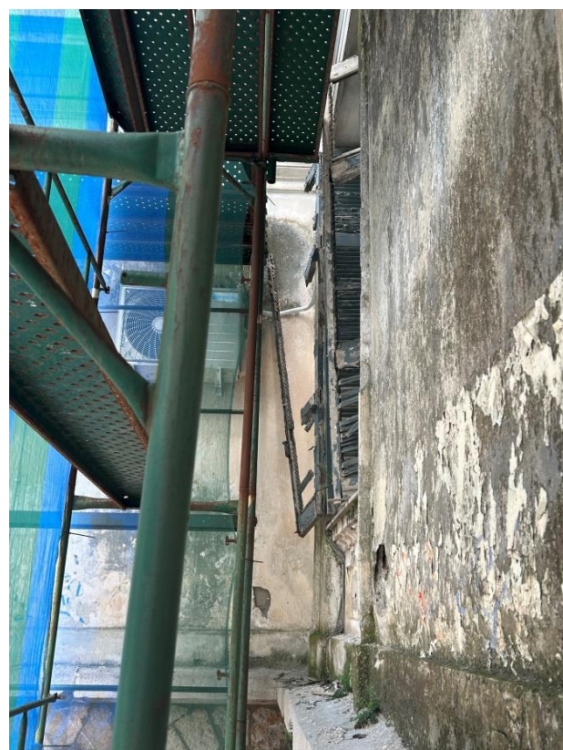
Φωτογραφία 8: Αποκόλληση παραθύρου με κίνδυνο πτώσης στο πεζοδρόμιο
