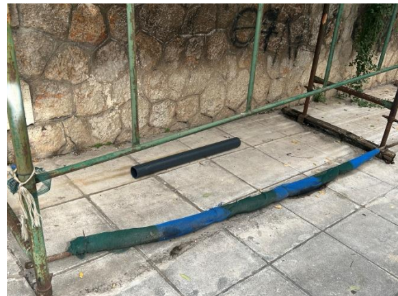
Φωτογραφία 23: Απώλεια στήριξης μεταλλικής δοκού στο πεζοδρόμιο
