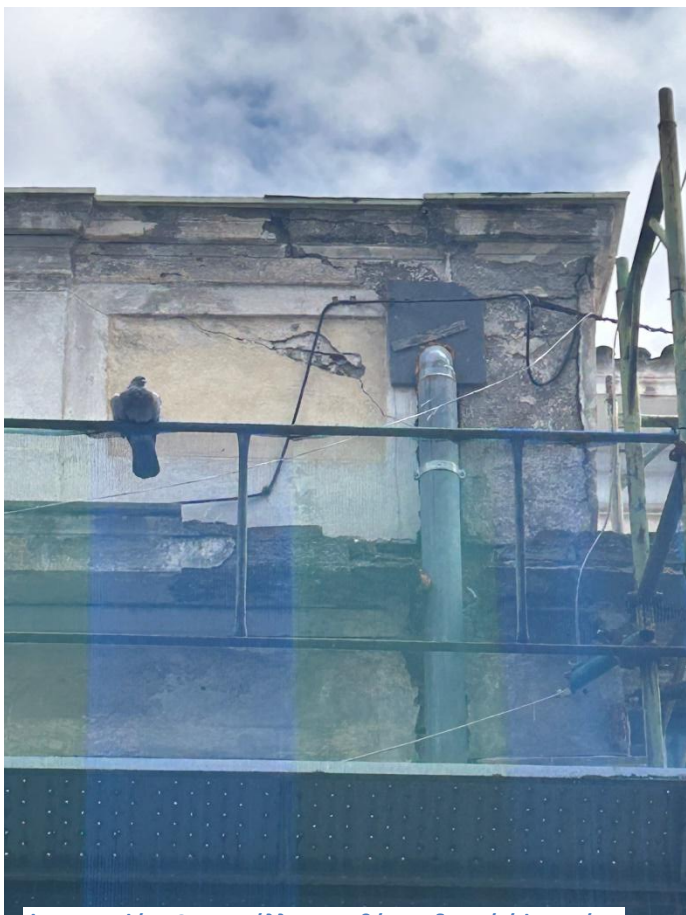
Φωτογραφία 13: αποκόλληση σοβά στη δυτική όψη από την οδό Λεωσθένους κάτωθεν του γείσου
