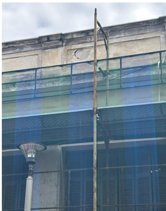
Φωτογραφία 21: Οξείδωση μεταλλικών στύλων ικριωμάτων
