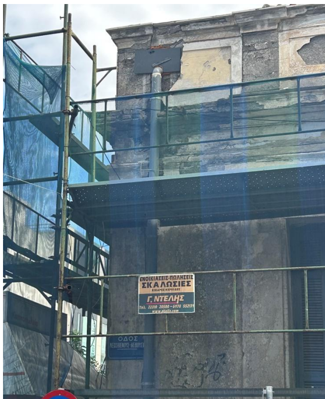
Φωτογραφία 16: Ρηγματώσεις και αποκόλληση τμήματος των διακοσμητικών κορνιζών, στα γείσα και τη στεψη του κτιρίου στη γωνία της οδού Λεωσθένους
