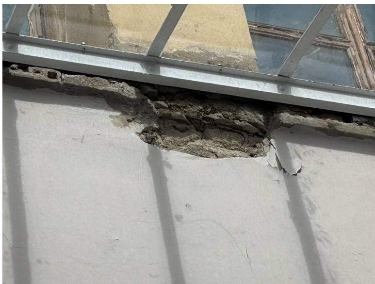
Φωτογραφία 20: Λεπτομέρεια αποκόλλησης επιχρίσματος στο σημείο αγκύρωσης μεταλλικού υαλωτού στεγάστρου
