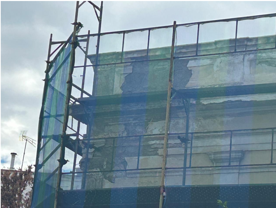
Φωτογραφία 18: Αποκολλημένα επιχρίσματα στη στέψη του κτιρίου επί της οδού Καποδιστρίου (ανατολική γωνία κτιρίου)
