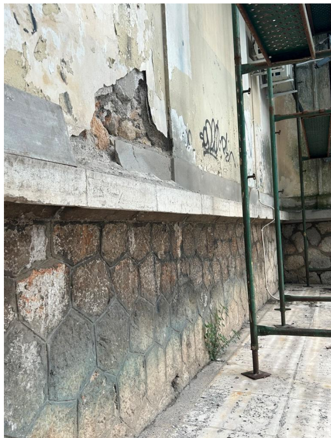
Φωτογραφία 14: αποκόλληση επιχρίσματος με αποκάλυψη του φέροντος οργανισμού του κτιρίου
