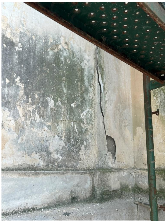
Φωτογραφία 11: ρηγματώσεις επί του επιχρίσματος λόγω διάβρωσης
